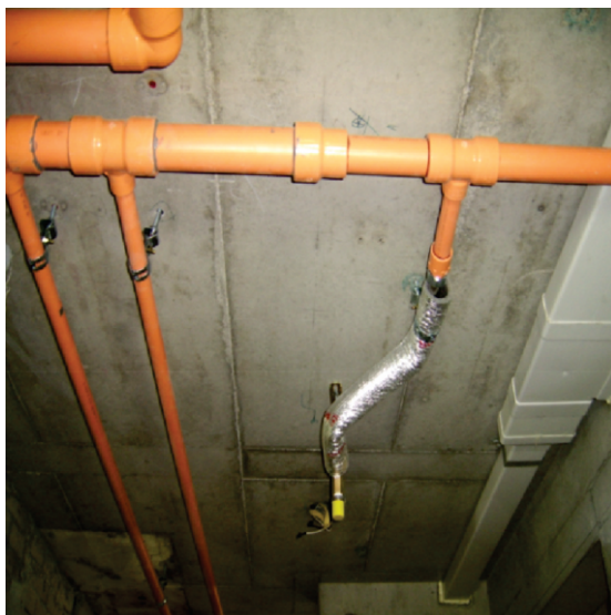
Đường ống phun nước ở căn hộ
