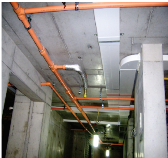
Đường ống phun nước ở căn hộ
