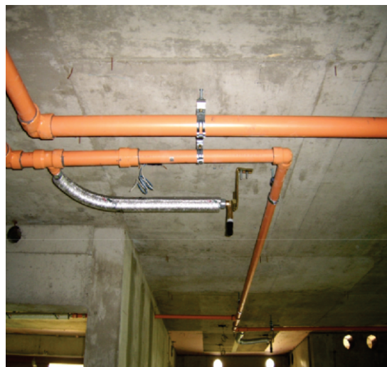
Đường ống phun nước ở căn hộ
